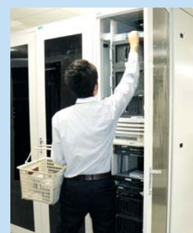
サーバのテープ交換
